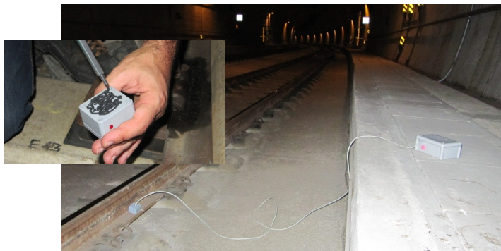
Monitorización de vía en los túneles de acceso a Valencia
